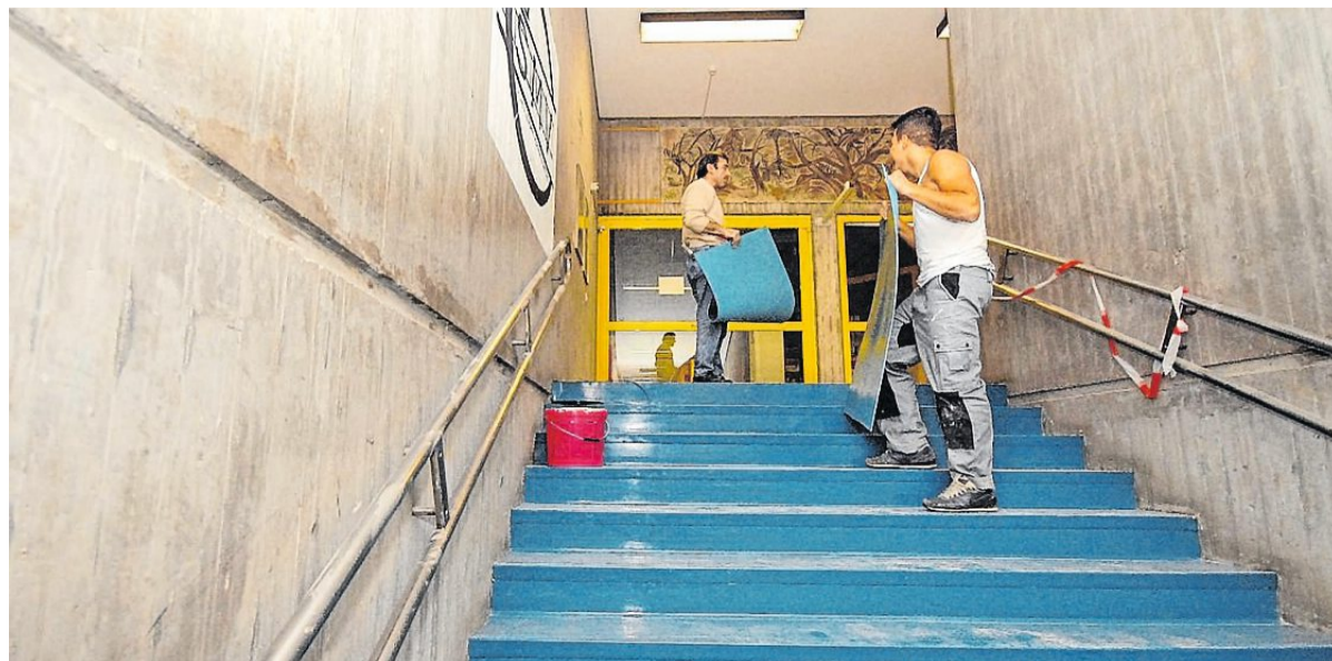
Immer wieder wird im Schulzentrum in kleinerem Maßstab renoviert, wie hier im Oktober 2013. Doch Generalsanierung oder Neubau überfordern die Finanzen der Stadt. ARCHIVBILD: SCHWETASCH
