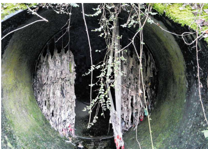
An der Stahltür des Entlastungskanals, der Regenwasser in den Altrhein leitet, haben sich unzählige Reste von Tüchern und Ähnliches festgesetzt. Ein Fanggitter am vorgeschalteten Überlaufbauwerk soll Unrat künftig verhindern. ARCHIVBILDER BRÜCKL
