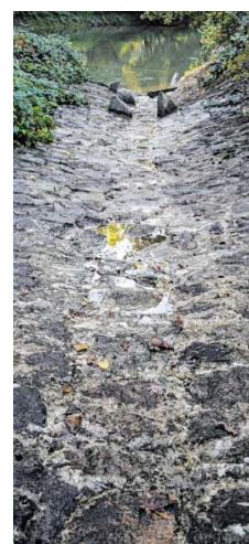
Von der Kanaltür aus gelangen die Verunreinigungen später in den Altrhein.
